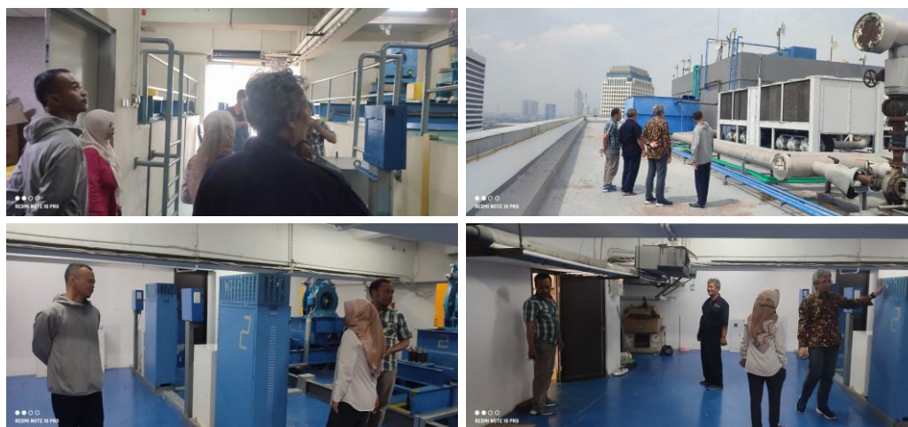
Gambar 59. Pengelolaan Mekanikal Elektrik dan Lift di Gedung E Kemendikbudristek
